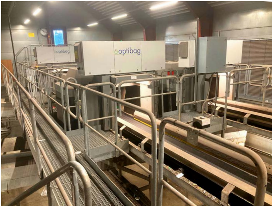
SNART SLUTT: Optibag-anlegget hos ØRAS har sortert matavfall fra restavfall i mer enn 25 år. Men ikke uten oppgraderinger, den siste ble gjort i 2017 og kostet 8 millioner kroner. Nå synger anlegget, i hvert fall foreløpig, på siste verset.
