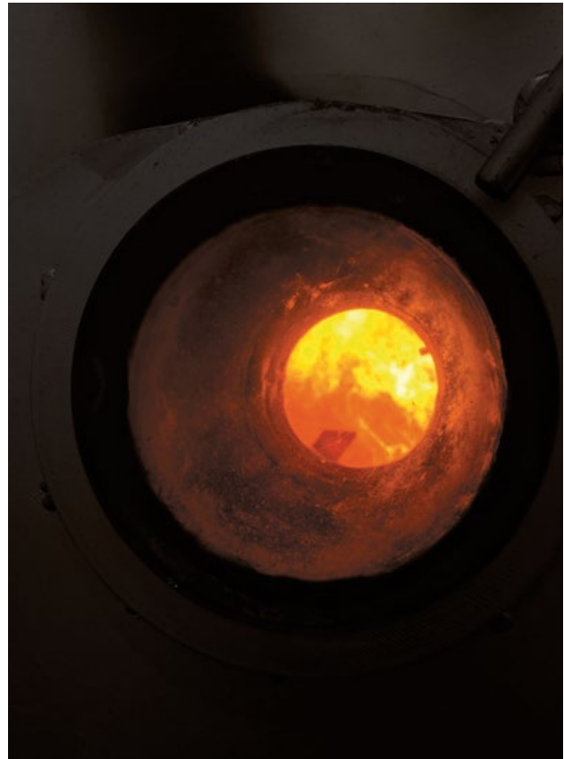
ØRAS sitt pyrolyseanlegg ligger inne på Miljøstasjonen. Foto: ØRAS
