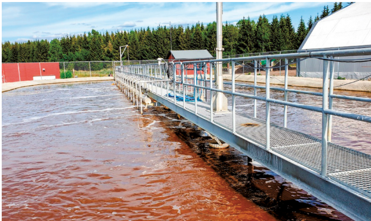
Renseanlegget har hatt stabil drift i 2025. Her er et bilde av luftebassenget. Foto: ØRAS
